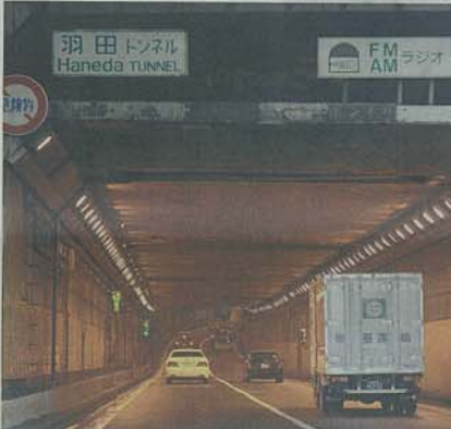
天井板の撤去作業が始まる首都高1号羽田線の羽田トンネル=22日午後、東京都大田区
